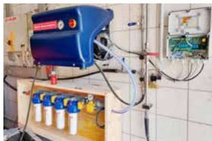
► Die Steuereinheit in der Futterkammer montiert
