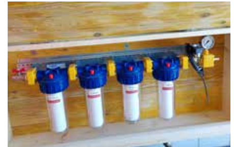
► Nur mit ausreichend gefiltertem Wasser funktioniert die Anlage
