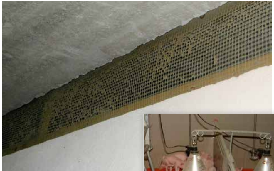
► Verklebte Zuluftgitter kosten Luftleistung
